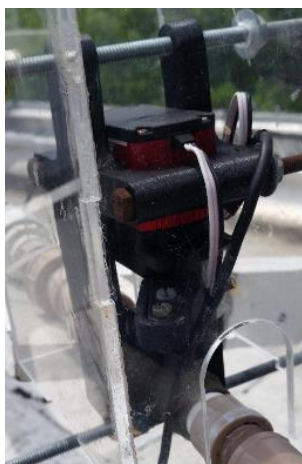
Figura 7 – Válvula de Controle.
